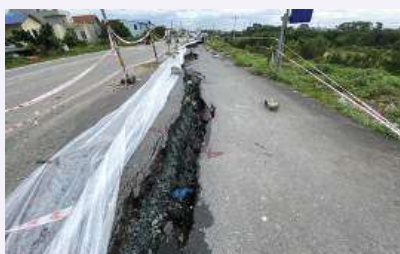
Hình ảnh sạt lở tại đê hữu Đáy trên địa bàn huyện Quốc Oai
