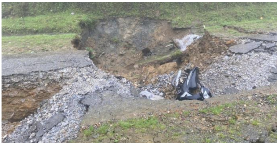
Mưa lớn gây sụt lún Tỉnh lộ 155, tỉnh Lào Cai
