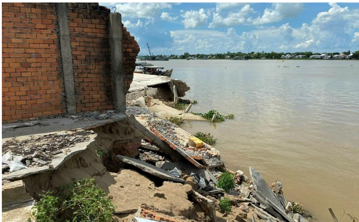
Sạt lở bờ sông Hậu, tỉnh An Giang
